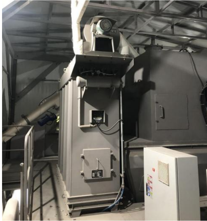
搅拌系统除尘装置及排气筒
