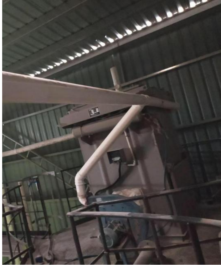
筒库顶部脉冲除尘装置及排气筒
