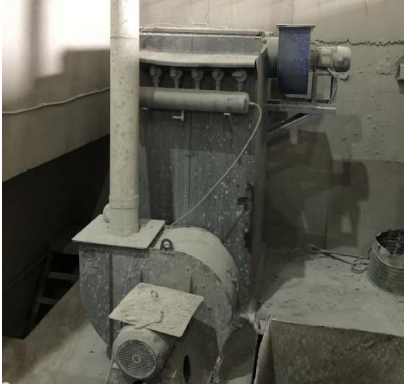
破碎筛分系统除尘装置
