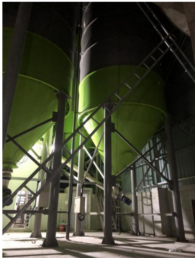
水泥、矿粉、粉煤灰筒库
