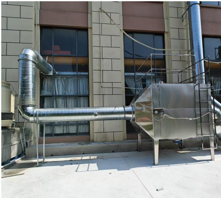
废气处理设施（柱状活性炭吸附）
