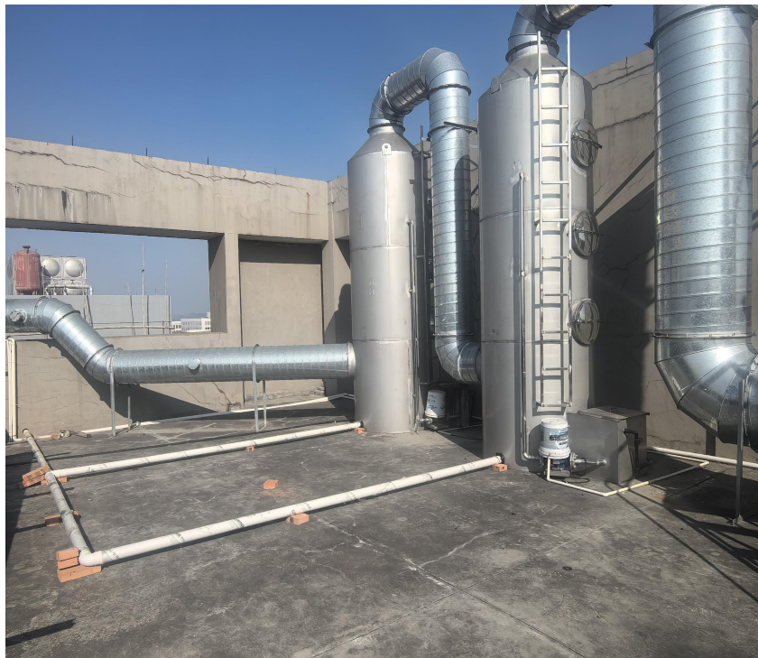
废气处理设施（两级水喷淋）
