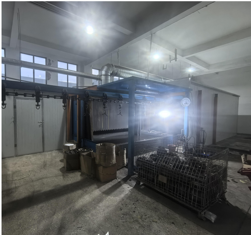
3F 喷漆流水线及水帘喷台
