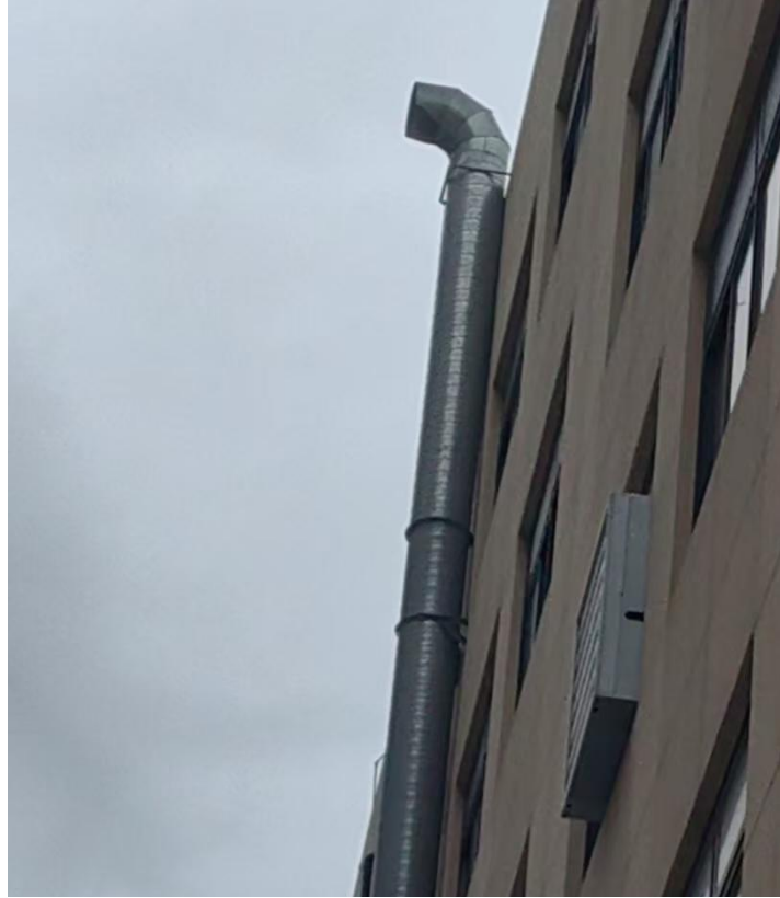
投料、混料粉尘排气筒（DA001）
