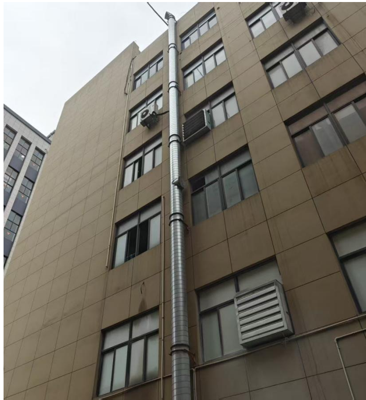
造粒废气排气筒（DA002）
