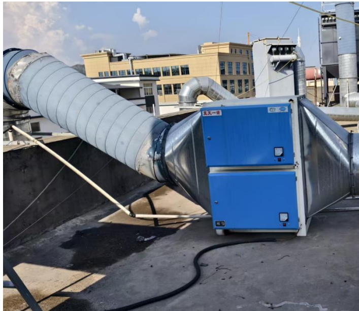
脱模废气处理设施（静电除油）
