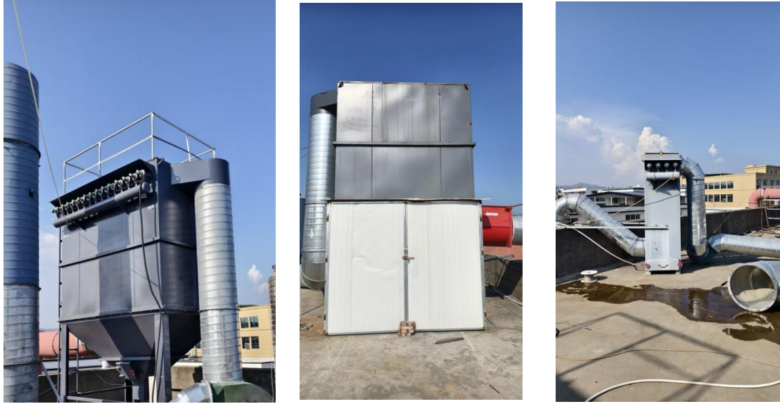
抛光废气处理设施（布袋除尘）
