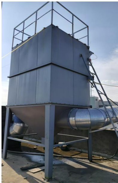
熔化废气处理设施（布袋除尘）
