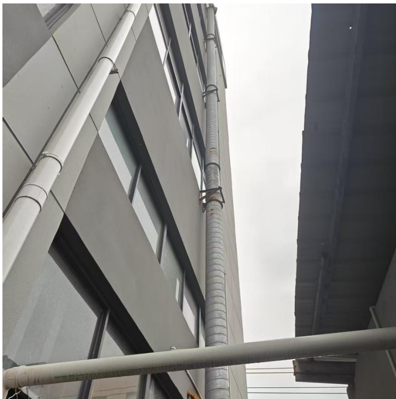
抛丸粉尘排气筒 (DA001)
