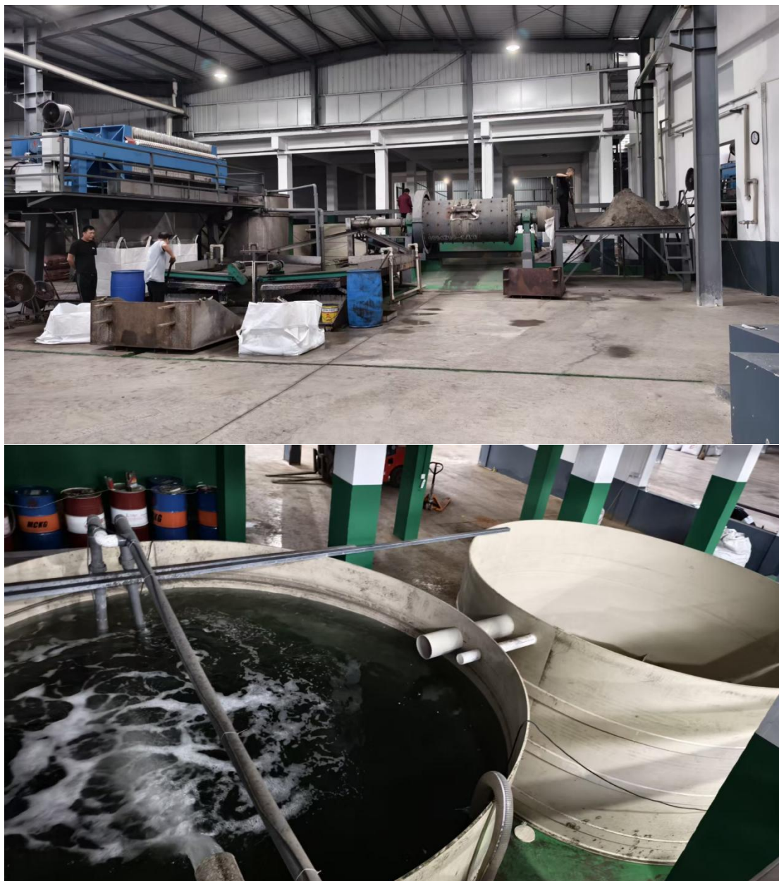
废水处理设施
