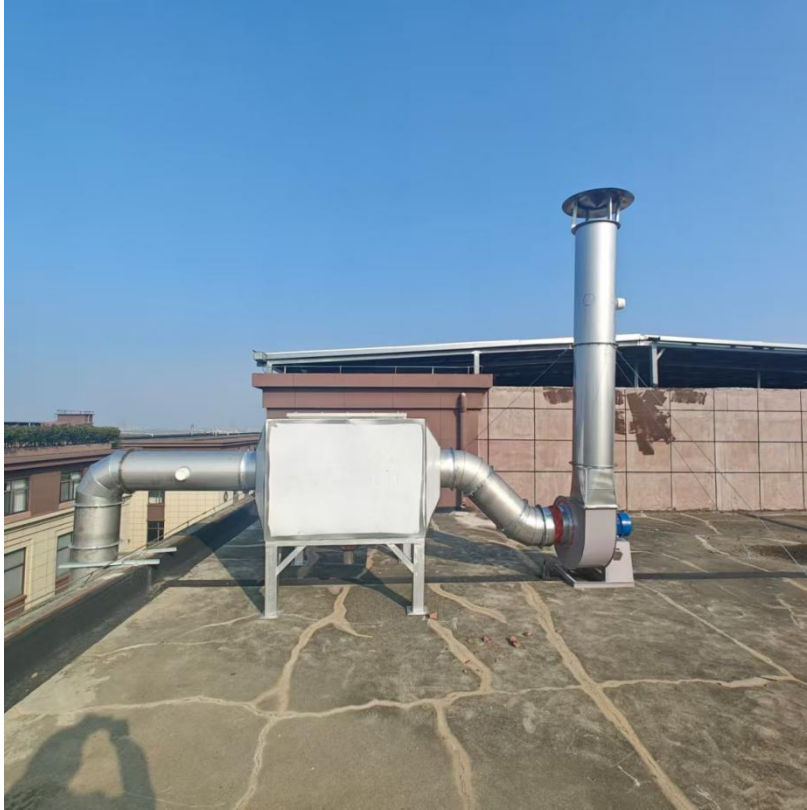
废气处理设施（活性炭吸附）
