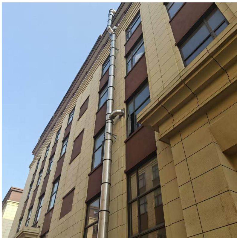
注塑废气排气筒 (DA001)
