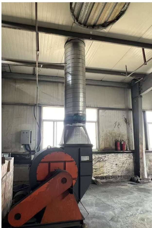
注塑废气排气筒 DA001
