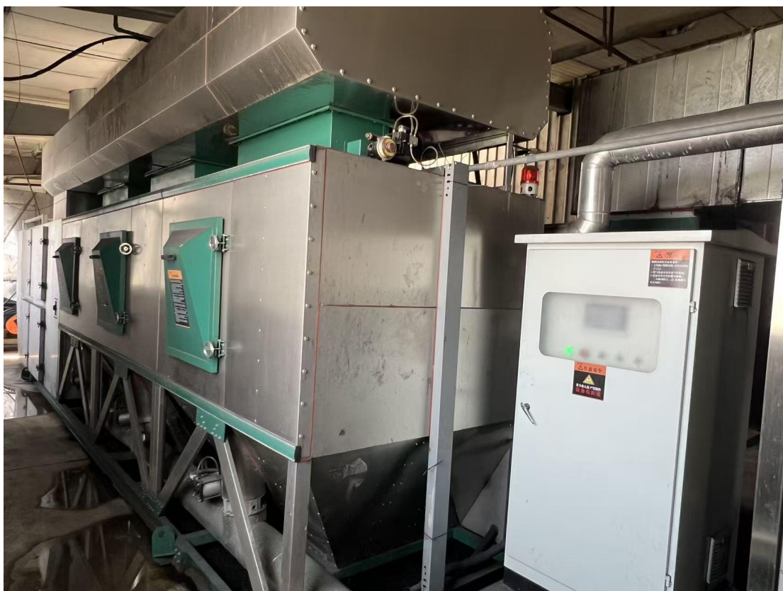
TA006 漆雾洗涤塔+干式过滤+活性炭吸附
