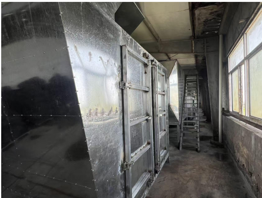
TA001 干式过滤+活性炭吸附装置
