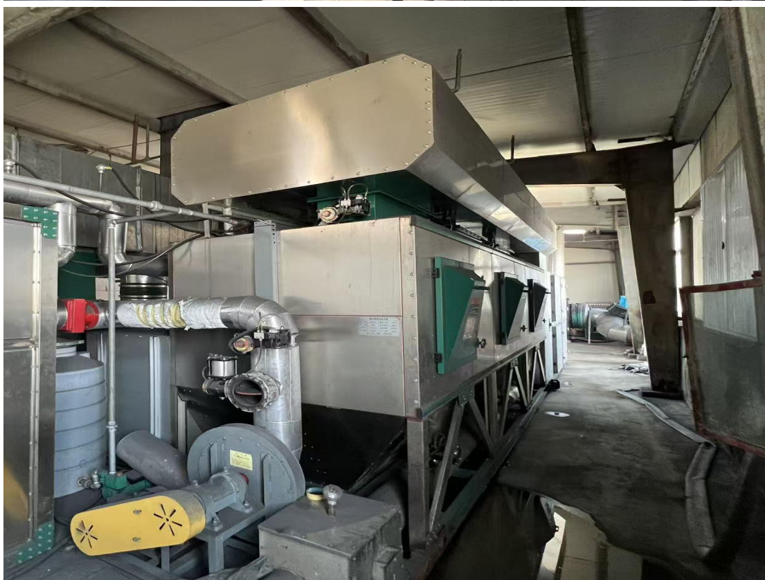
TA007 漆雾洗涤塔+干式过滤+活性炭吸附
