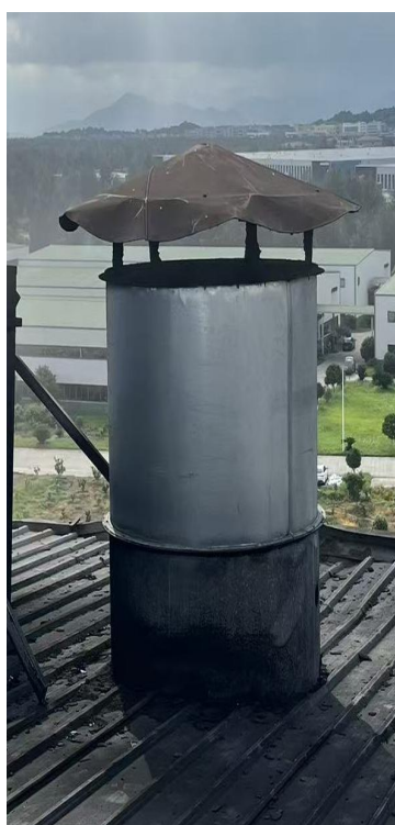
DA004 油性漆喷漆废气排气筒
