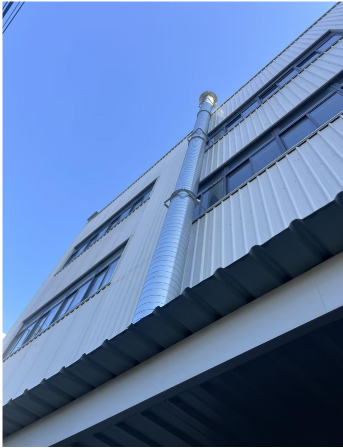
注塑废气排气筒
