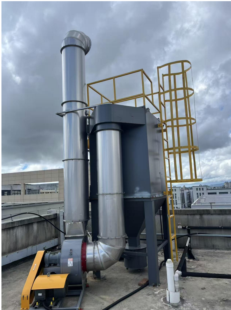
锻打废气处理设施：布袋除尘器及排气筒 DA002
