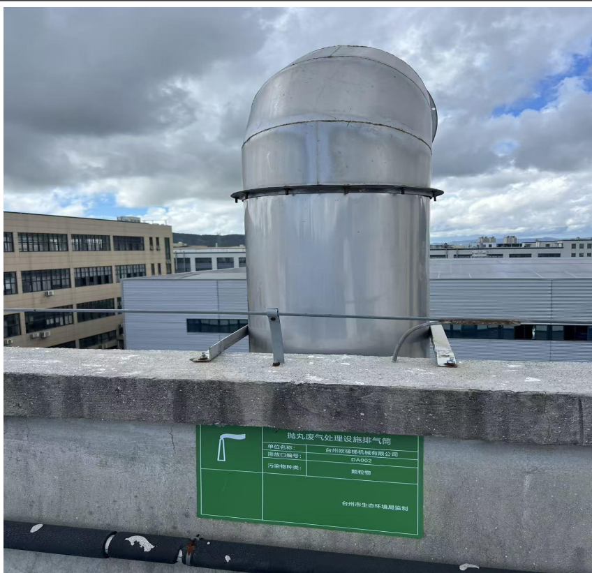
抛丸废气排气筒 DA003
