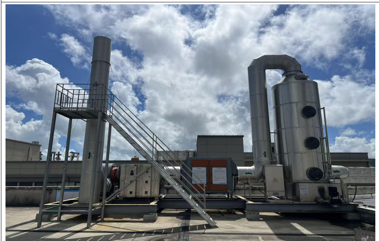
热处理废气处理设施：喷淋塔+干式过滤器+油雾净化装置及排气筒 DA001
