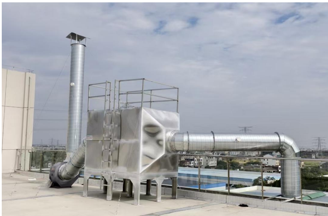
注塑废气处理设施
