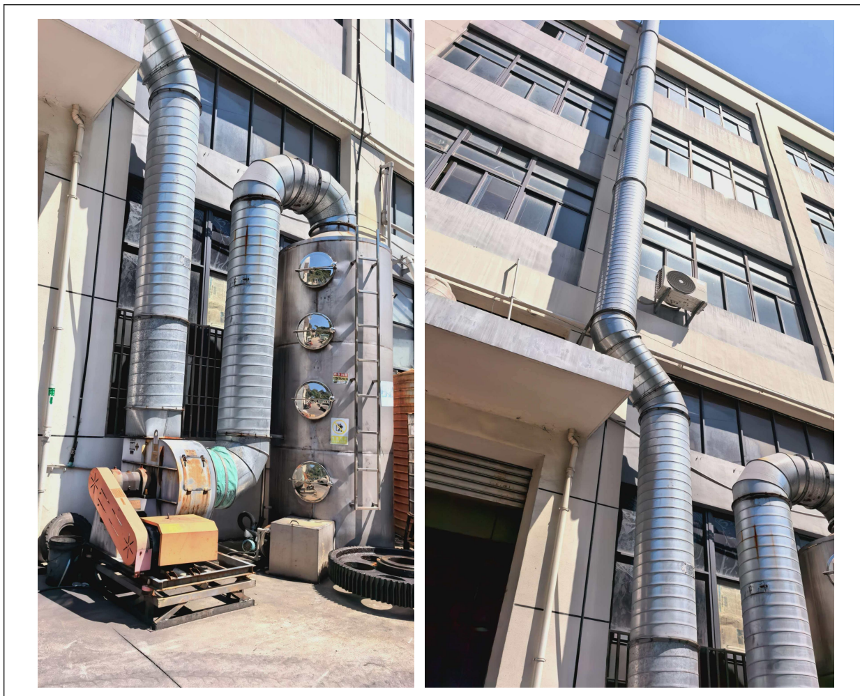
红冲废气处理设施：水喷淋及排气筒 DA001
